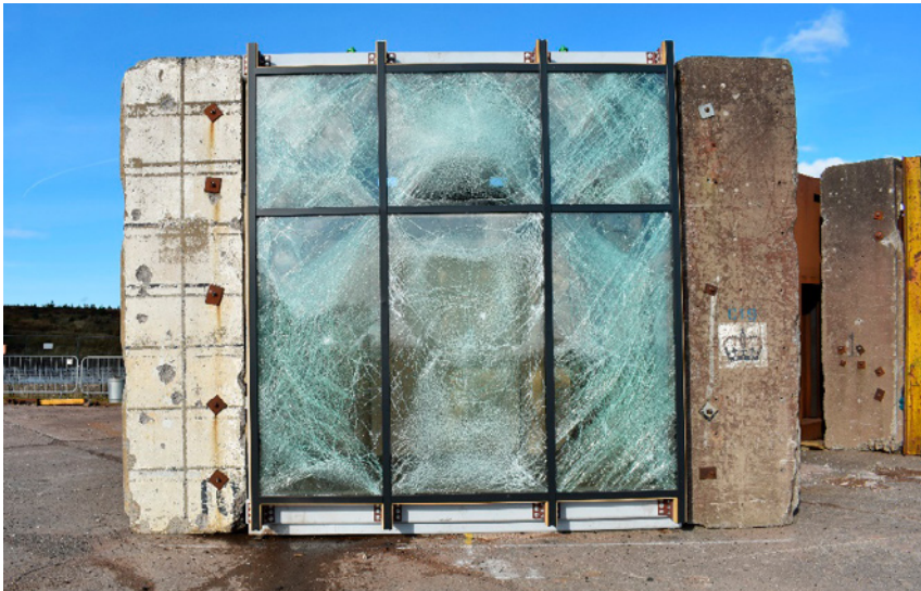
Abbildung 55: Beispiel einer durch eine Druckwelle beanspruchten Fassade nach einer Explosion (Bild mit freundlicher Genehmigung der Sälzer GmbH, Marburg, Deutschland)
